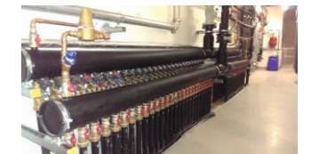
GT-System nach der Fertigstellung des Gebäudes und Inbetriebnahme der Anlage
