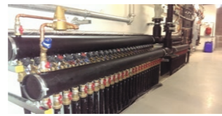
GT-System nach der Fertigstellung des Gebäudes und Inbetriebnahme der Anlage
